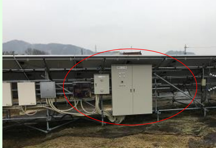
実証プラント：電源制御盤
